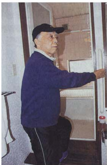
認知症初期集中支援チームのアドバイスで、段差のある浴室の入り口に手すりがついた。分部さんは「風呂に入りやすくなった」と喜ぶ—東京都世田谷区で
